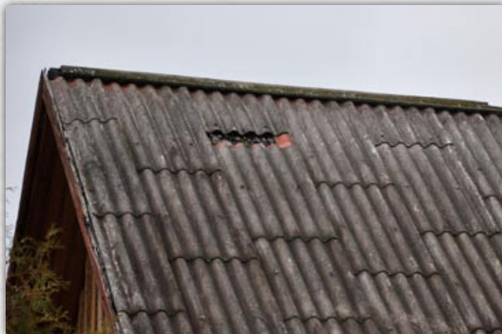
Ka väike auk katuses võib pikaajaliselt põhjustada konstruktsioonides mädaniku teket.
